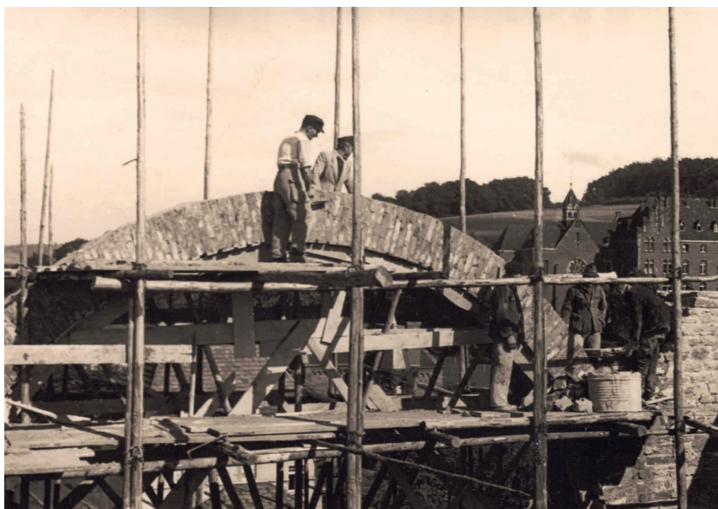
Wiederaufbau der Pfarrkirche St. Michael in Geistingen, im Hintergrund das Kloster Geistingen, um 1950. Foto: AEK, Bildsammlung Pfarreien 1001893
